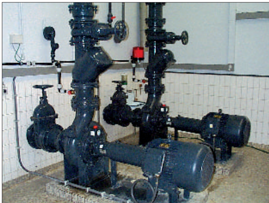
Насосы Robot “сухой” установки – правильное решение для систем перекачивающих сточные воды. Сверху: 2 насоса модели ВТ6050, осуществляющие перекачку сточной жидкости в аэропорту Амстердама “Шифол”.
