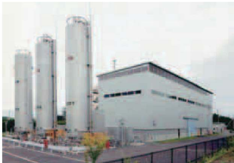
Криогенный центр для испытания насосов
