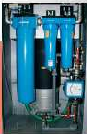
Генераторная установка для азота
