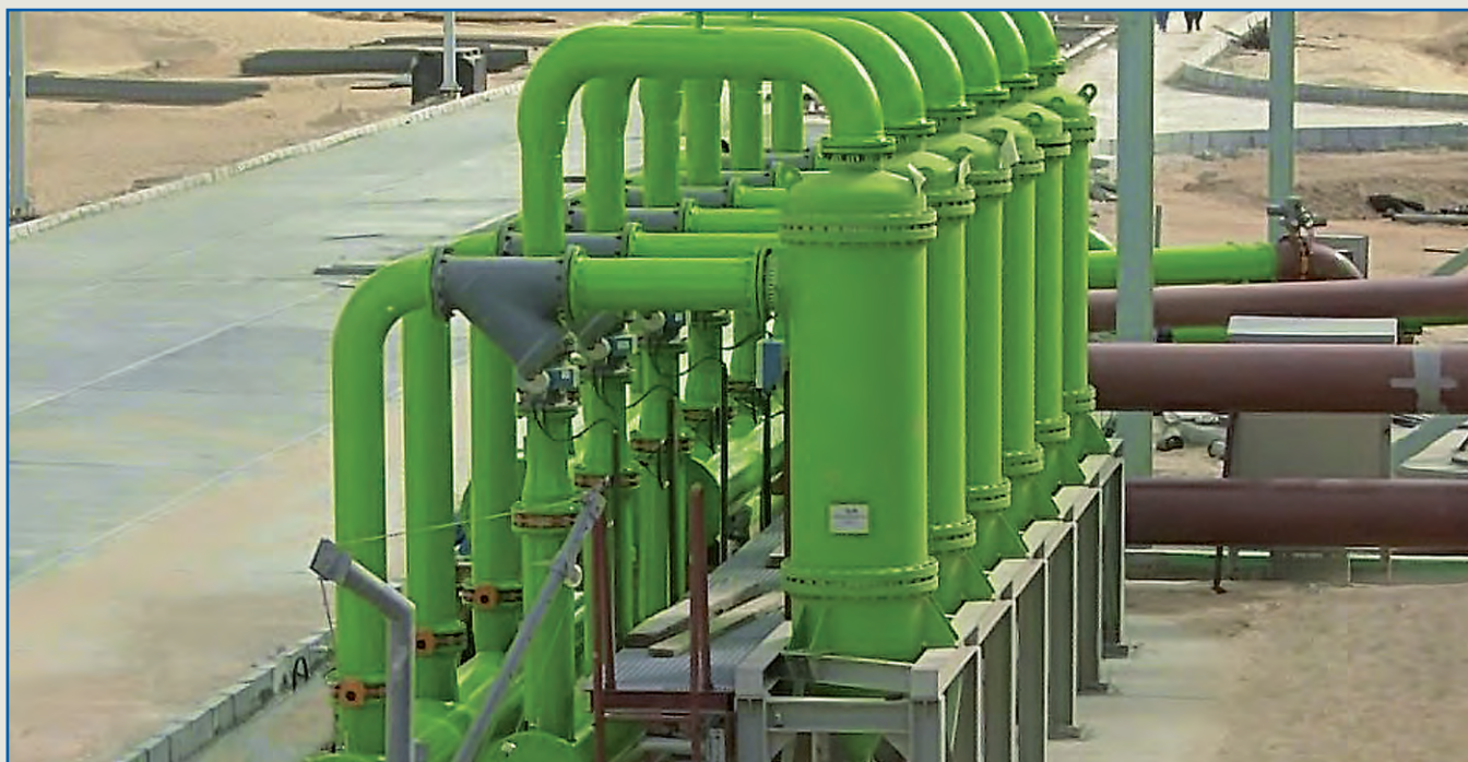
Рис. 7 Фильтрация sprысковой воды на прокатном стане.
